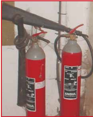
Figuur 58: Een koolzuurgasblusser met specifieke spuitmond
